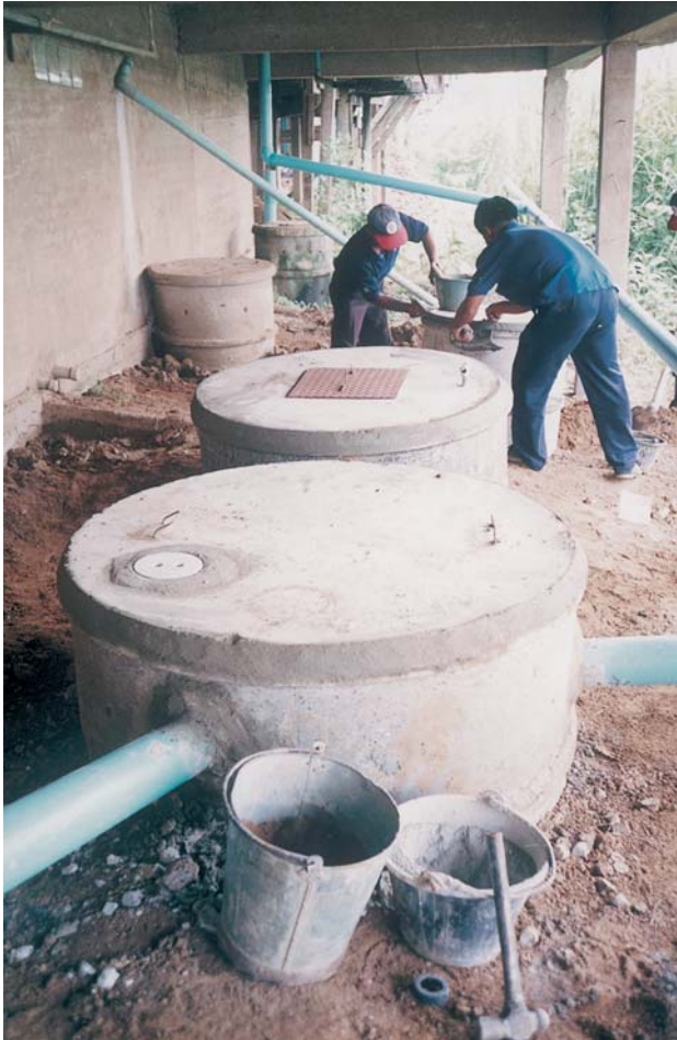
การติดตั้งระบบบำบัดน้ำเสียแบบถังกรองไร้อากาศชนิดวงขอบซีเมนต์
